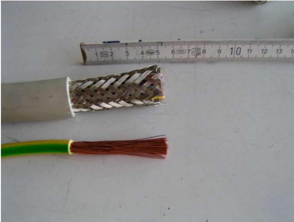
Bild. 3.1: z.B. Kabel JE-LIYCY 32x2x0.5 für Kontakt-Rollfeder SA KRF 22 V2A und PE 1x16 mm 2 (mehrdrätig) ca. 5 cm abisolieren.
